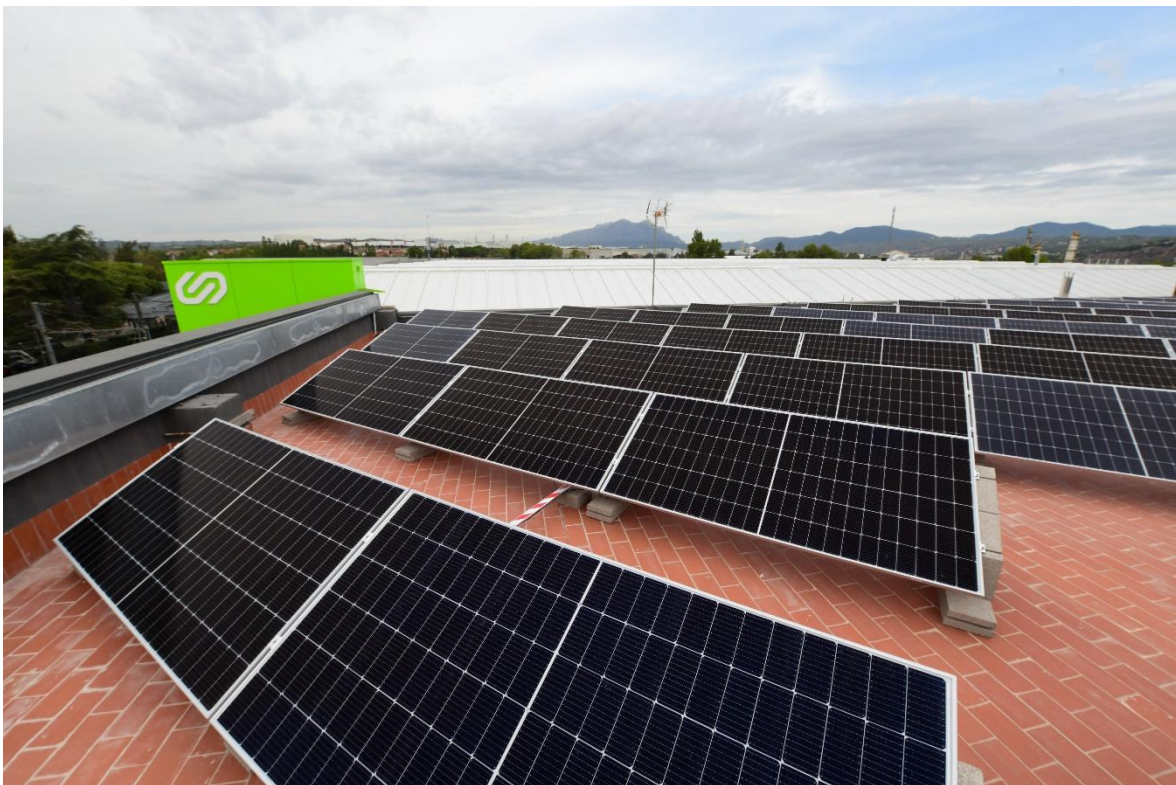
Imatge de les plaques solars instal·lades a la coberta del Centre Operatiu de Martorell
